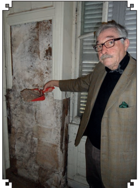
Une partie de l'état désastreux du salon.
